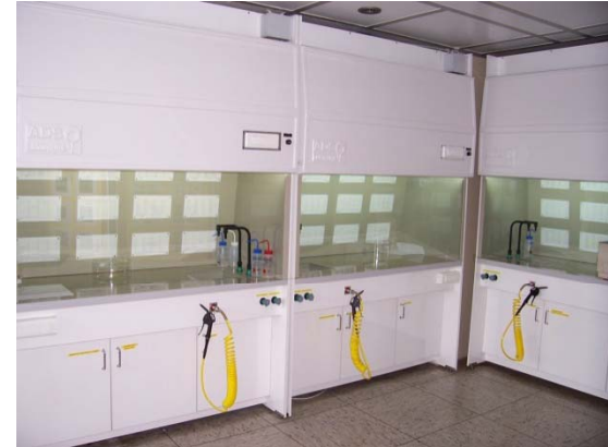
Poste de travail sous hôtes aspirantes
